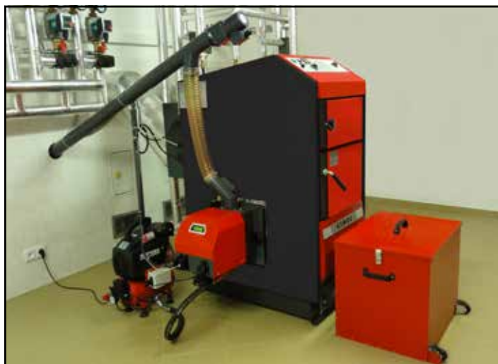
Příklad kotelny s kotlem D50P
