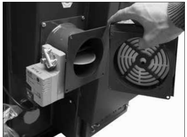
Inspektion und Reinigung des mit einem Regulationsklappe ausgestatteten Luftkanals
