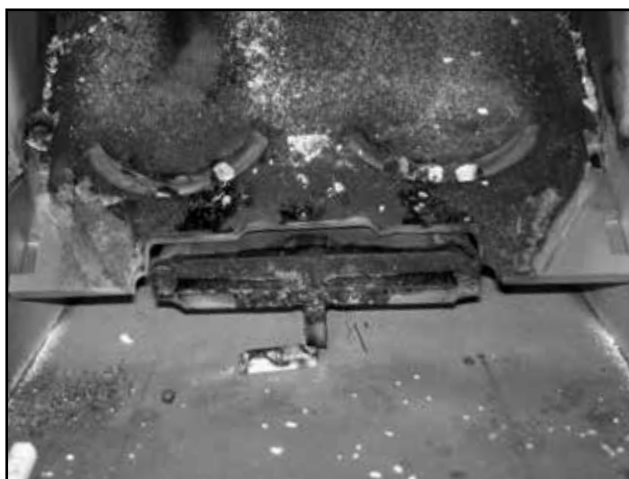
Exemple de l'encrassement léger après 4 mois d'utilisation
