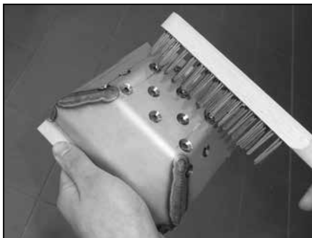
Exemple du nettoyage de la chambre de combustion après 4 mois de service
