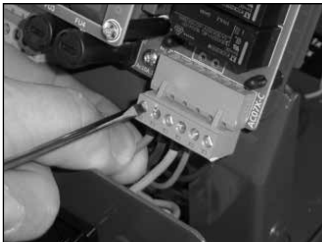
Le raccordement de la commande du compresseur aux bornes du module d'extension AC07X-C pour les chaudières DxxPX et PXxx, le conducteur brun L à la borne R5 (1), le conducteur noir à la borne (2)
