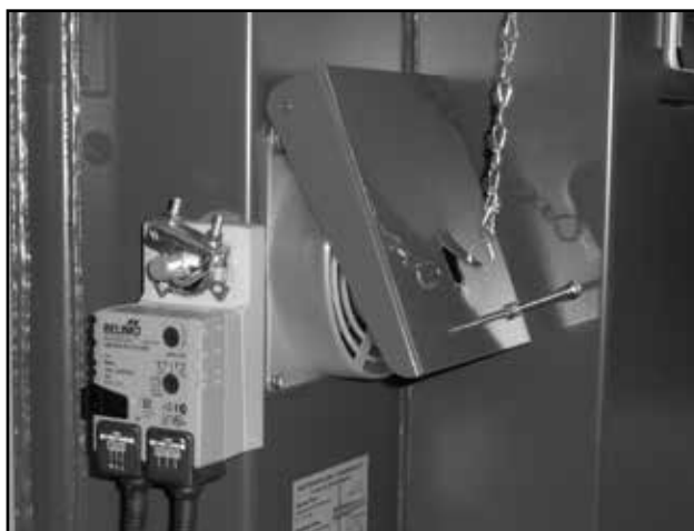
Arrivée d'air de combustion dans la chaudière DCxxSP est fermée automatiquement par le servomoteur Belimo
