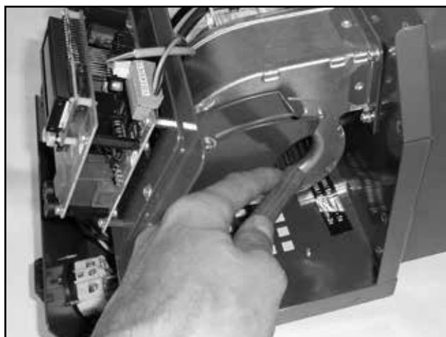
Exemple du nettoyage (soufflage) de la roue portante du ventilateur de pousse du brûleur une fois par saison.
