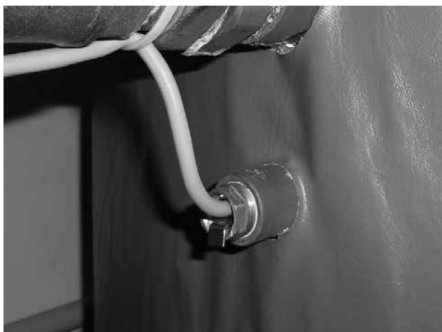
Rys. 13 – Widok czujnika temperatury wody podłączonego do zbiornika akumulacyjnego (TV i TS)
