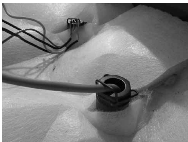
Rys. 16 - widok czujnika temperatury wody TK podłączonego do kotła typu DxxP, Pxx
