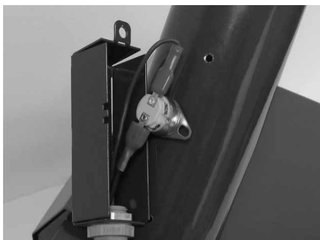
Rys. 10 - termostat bezpieczeństwa przy zasypie komory spalania, 95 °C (55 °C dla kotłów DxxPX, PXxx)
