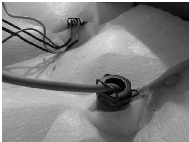
Fig. 16 - vue du capteur de température de l'eau TK dans le bac de la chaudière DxxP, Pxx
