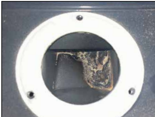
Ukázka zanesení po 3 měsících provozu s nadrcenými peletami s velkým obsahem prachu
