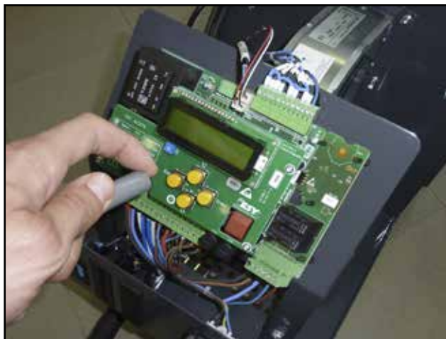
Ukázka čištění (vyfoukání) prostoru uvnitř hořáku. (bez el. proudu!)
