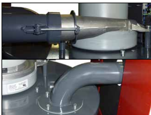
Připojení výfukového potrubí k ventilátoru
